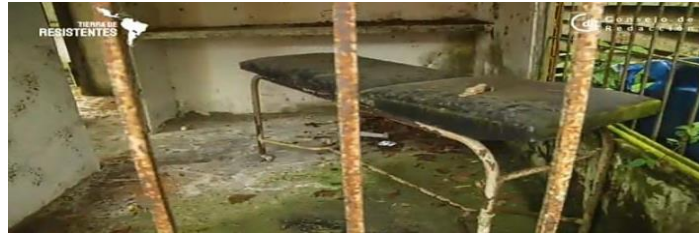
Figura 6. Puesto de salud, afectado por el conflicto
