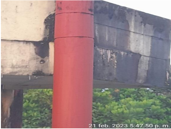
Ilustración 13 AFECTACION EN LA TERRAZA
