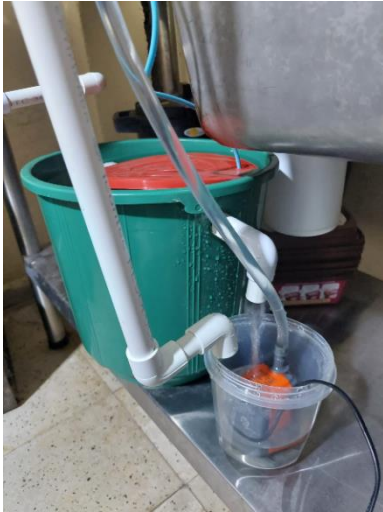
Figura 4. Bomba y recepción de agua.
